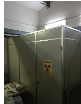
新設:放射化物保管設備
