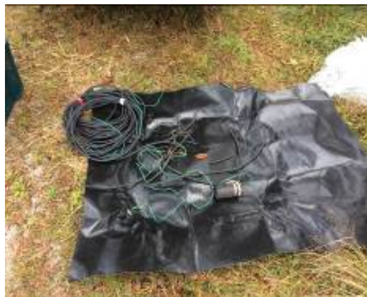
図 16. ケーブル破損
