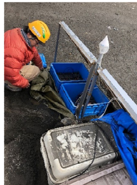
図10 バッテリー交換
