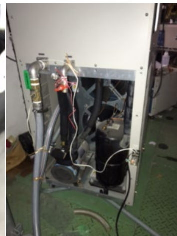
写真4 国産チラー内のポンプに接続された延長ホース
